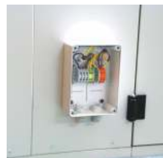
instalacja elektryczna zakończona puszką
